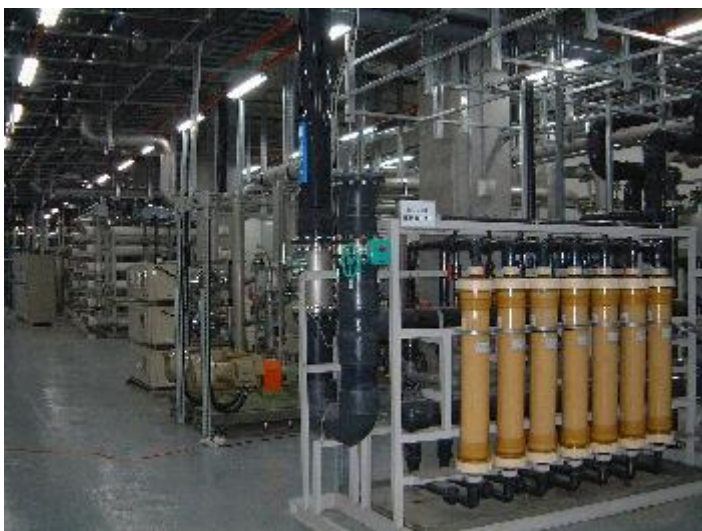
Figuur 3. Installatie voor omgekeerde osmose
